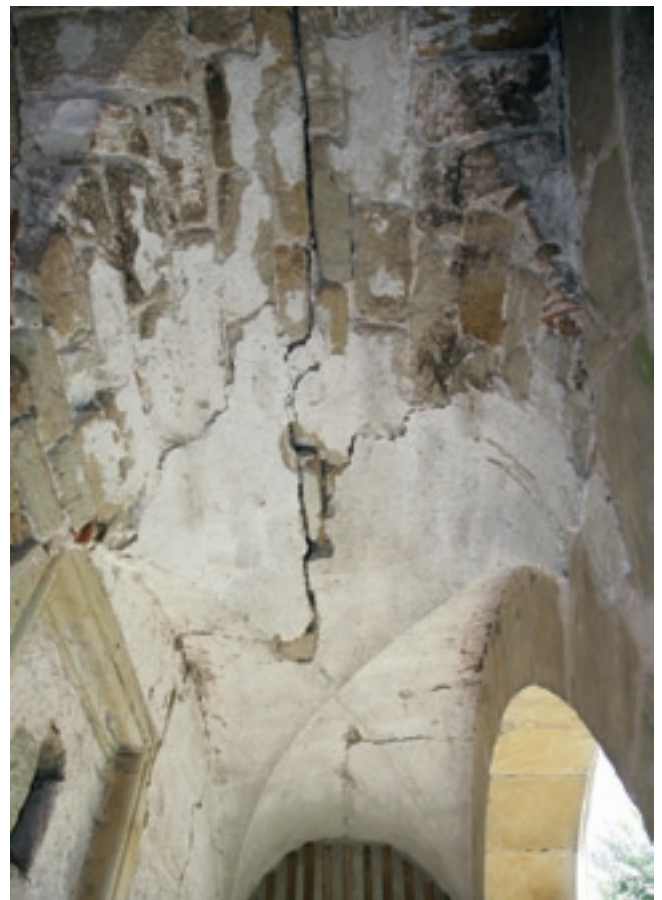
Deckengewölbe; akut gefährdet
